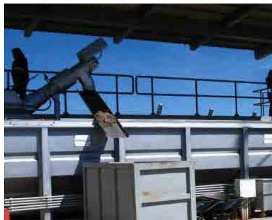
Foto 59. Limpiadores mecánicos de rejillas
