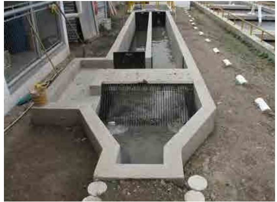
Foto 60. Desarenador de dos celdas
