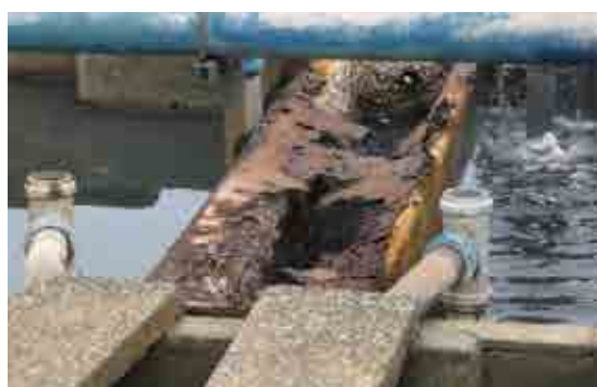
Foto 48. Dispositivos deteriorados totalmente
