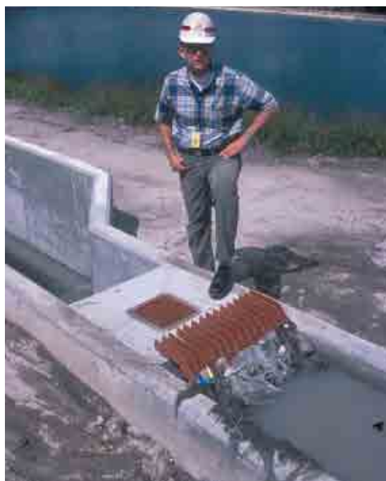
Foto 47. Acumulación de sólidos en las rejillas
