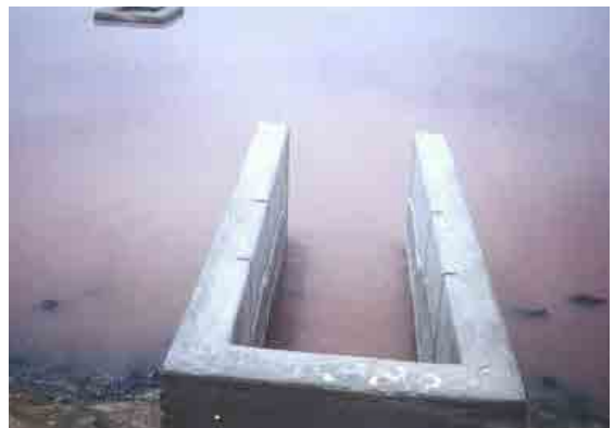
Foto 51. Arqueta de desagüe total
