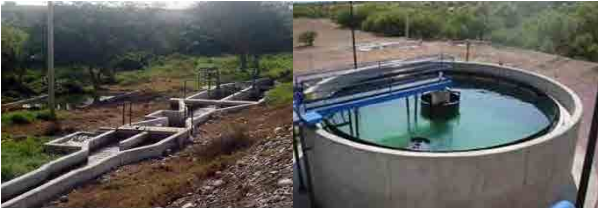
Foto 35. Cámara de rejas y desarenador Foto 36. Sedimentador primario
