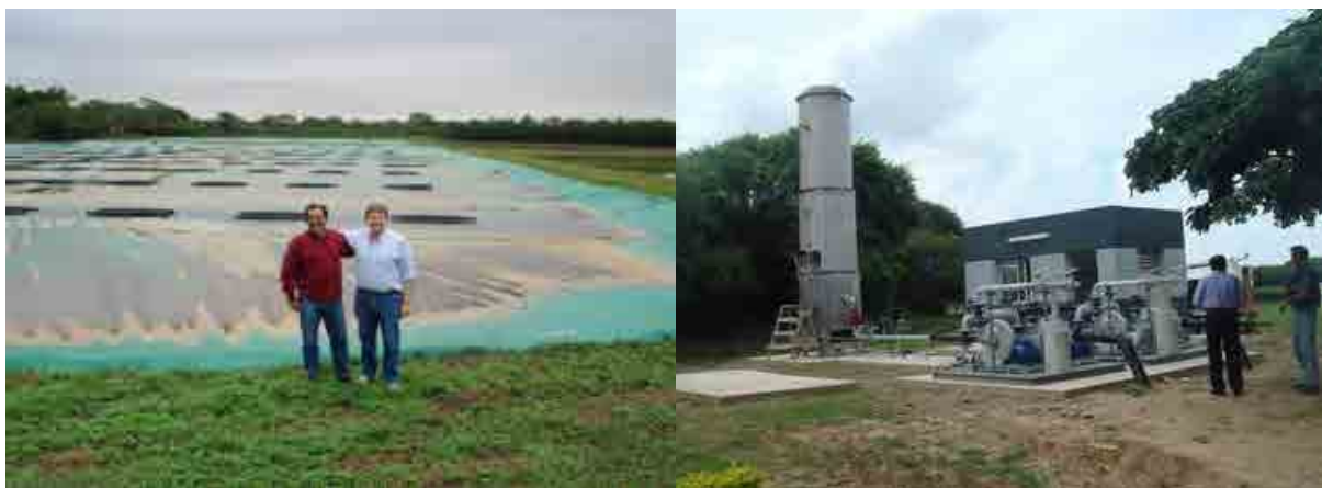
Foto 14. Lagunas anaeróbicas Foto 15. Quemador de metano en la Planta de SAGUAPAC en Santa Cruz, Bolivia
