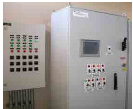
Foto 43. Sistema electrónico de automatización
